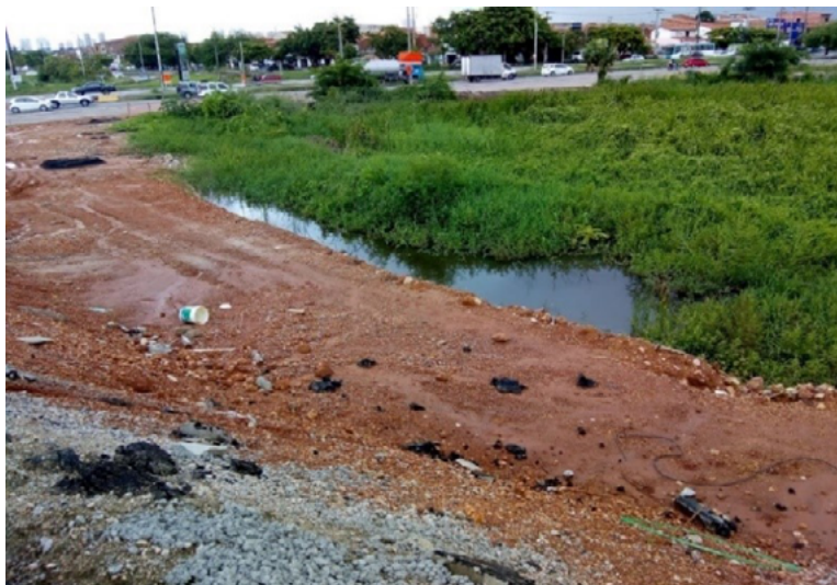
Figura 2 — Águas empoçadas em canteiros durante a obra
