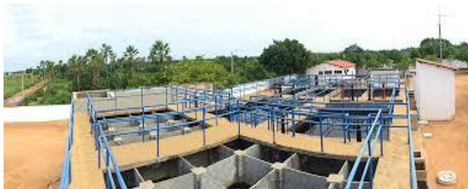
Figura 1 — Estação de tratamento de água do município de Limoeiro do Norte – Ceará
